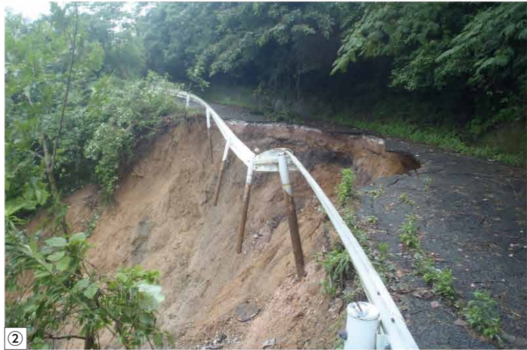
①豪雨で大きく崩落した山の斜面 ②無残にえぐりとられた山間部の道路 ③橋脚にぶつかり荒れ狂う濁流(彦山川) ④彦山川の橋をふさぐ大きな流木 ⑤田川文化センター裏の道路が陥没。住民の生活圏にも被害が及びました
