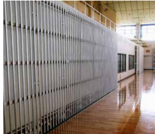
▲大体育室の壁面に設置した冷暖房設備の輻射パネルで、快適な環境を保ちます
