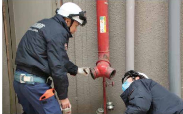
▲連結送水管を入念にチェックする消防署員
